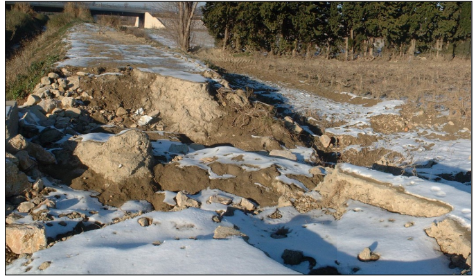
De nombreuses brèches se sont formées dans les digues de la plaine, causées à la fois par le Briançon et le Gardon
