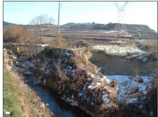
Pont contourné et érosion de la berge rive gauche au droit du point de retour de la crue (pont de la Gille)
