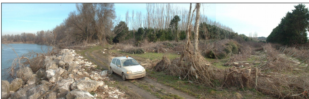
Protection de berge déstabilisée et vergers dévastés au droit d'un point de sortie de la trajectoire de crue (le Pradas)
