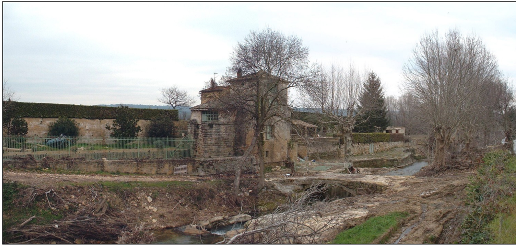
Le moulin de Sagriès, dévasté par la crue. Le niveau d'eau a atteint le pied de la haie située au fond à gauche de la photo
